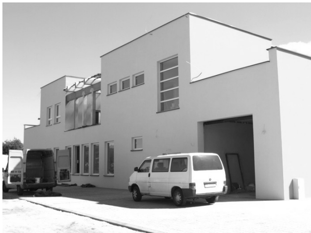
Budynek GOK w Zagórze z zewnątrz jest już gotowy. Obecnie trwają prace wykończeniowe wewnątrz budynku
