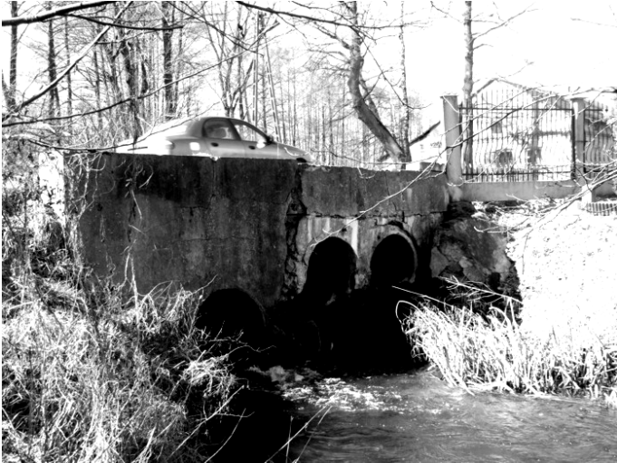
Zniszczony przepust pod drogą powiatową w Wielgomłynach ul... Zagórska
